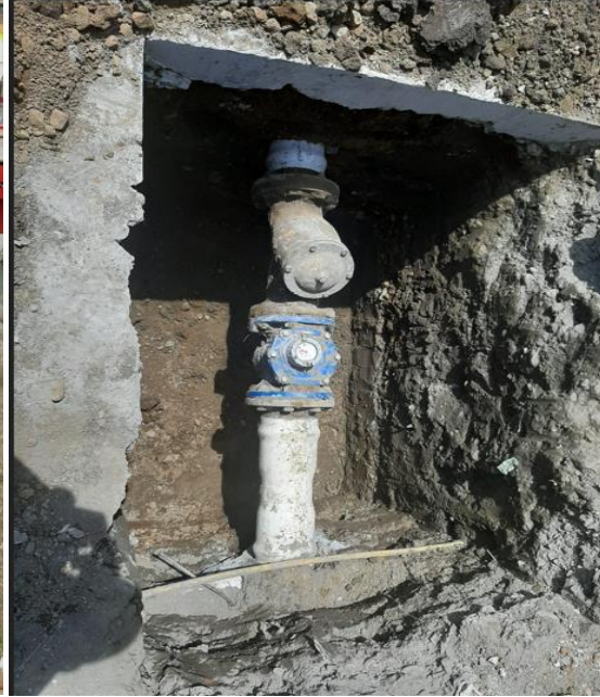
FOTO 4: LUGAR DE INSTALACION MEDIDOR
